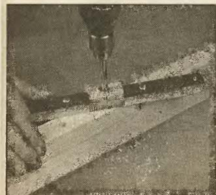
Keskenyebb anyagokhoz a helyezőcsapokat a belső, szélesebb munkadaraboknál viszont a külső furatokba kell helyezni
